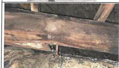
Photo n° PhTer006 Localisation : 2ème étage - Combles d'habitation Ouvrage : Charpente, Plancher Parasite : Anobium punctatum (Petites vrillettes), Champignon de pourriture fibreuse Indices : présence de trous de sortie, aspect du bois
